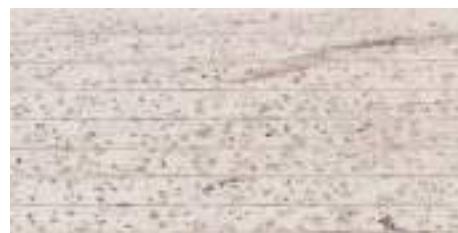
Taches de moisissure/champignons à la surface
