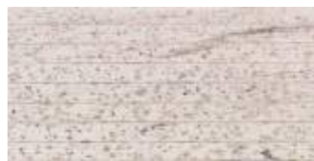
Taches de moisissure/champignons à la surface
